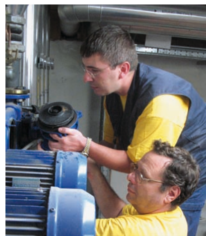
14:30: Salta una pompa dell'acqua al CESA a Trigatoria. Situazione sotto controllo: gli idraulici del Campus procedono alla sostituzione del motore.
